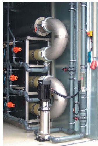
Abb. 6: Industrieanlage mit geregelter Pumpe
